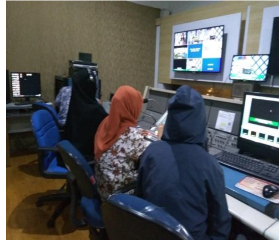
Gambar 11. Crew di Ruang Master Control
